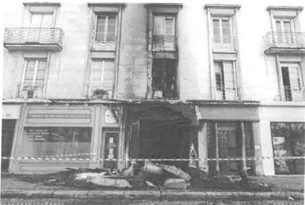
Détail de la façade du bâtiment à Tours, le jour de l'incendie. L'édifice a été l'objet d'une fermeture administrative en juin 2019. (Photo de M. Nicolas Mouton)
